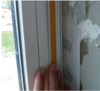
⑩ Vor dem Verputzen werden auf den Fensterrahmen Dicht- und Abschlussleisten geklebt.
