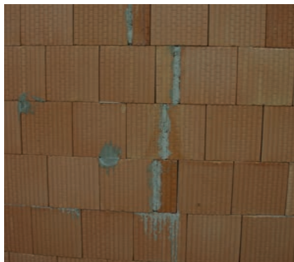
Im Bereich von Ziegelzuschnitten müssen die Fugen vollständig mit Mörtel ausgefüllt werden.
