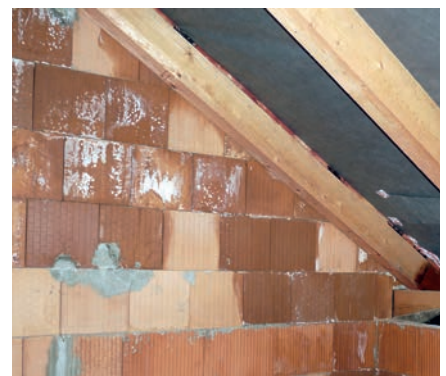
Ausblühungen am feuchten Mauerwerk müssen nach dem Austrocknen mechanisch gereinigt werden.
